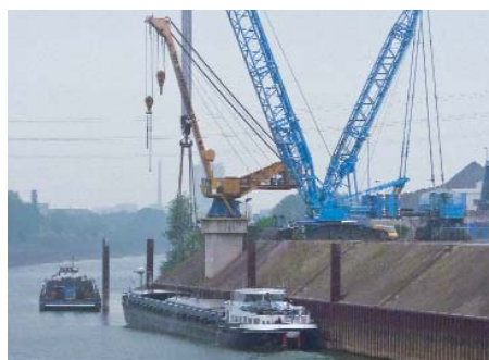
Im Felbermayr-Schwerguthafen Krefeld wurde der Trafo umgeschlagen.
