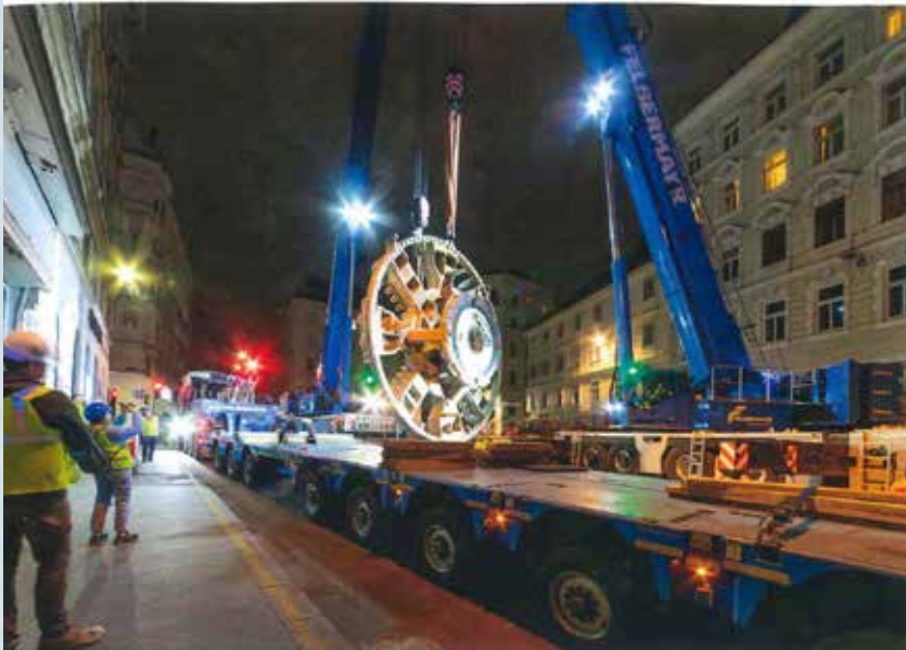
Das rund 78 Tonnen schwere Schneidrad wird im Tandemhub mit einem 400- und einem 250-Tonnen-Kran am Augustinplatz ausgehoben.
